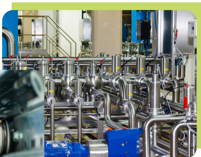
Maintenance préventive en IAA.
